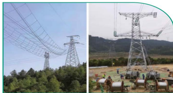
图22：黔南州新能源接网送出项目
