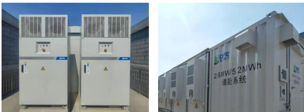
图 31：东方电子 2.6MW/5.2MWh 储能系统
