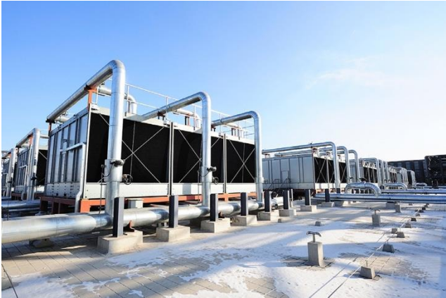
图表16：数据中心室外冷却塔
