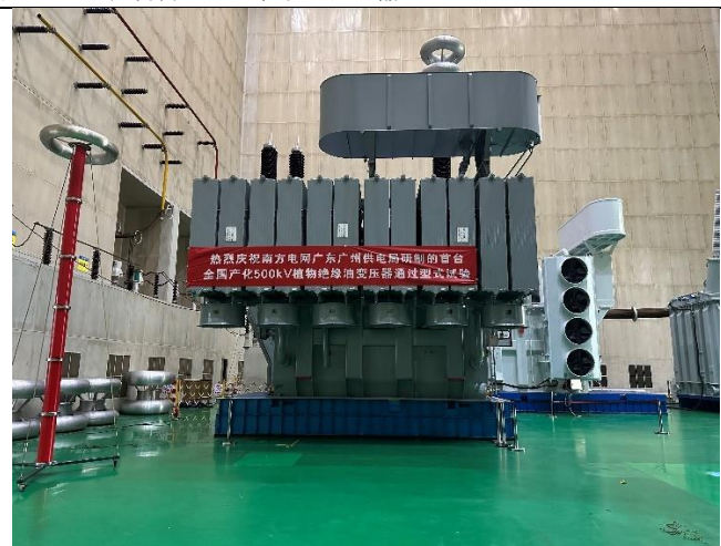
图 24: 我国首台 500kV 植物油变压器
