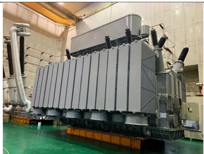
图 23: 我国首台 220kV 植物油变压器
