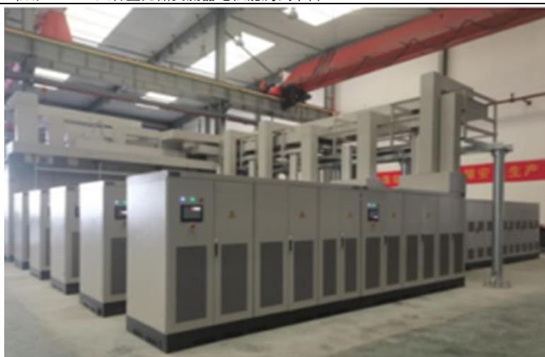
图 29：常州 7.5MW 大容量光储变流器电性能测试平台
