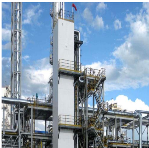
图：中泰股份的深冷净化装置——合成氨液氮洗装置
