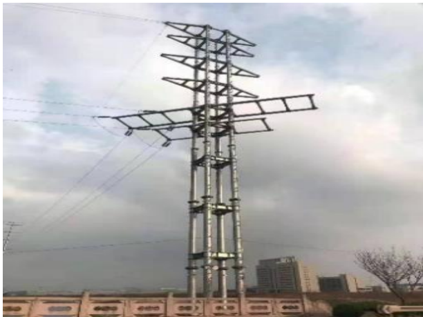
图16: 220 千伏四柱钢管杆
