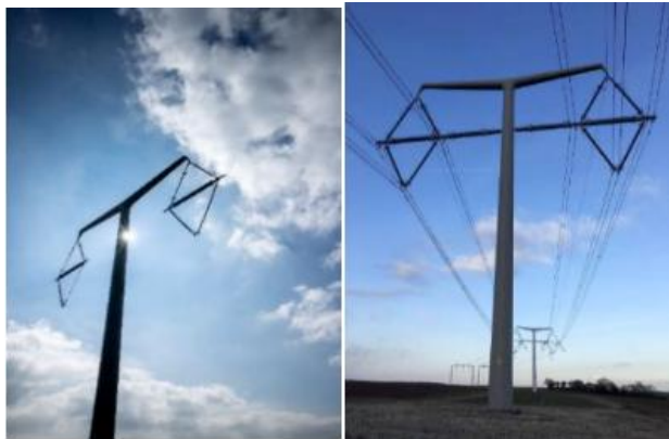
图26：英国国家电网公司 400kV 输电线路钢管杆项目
