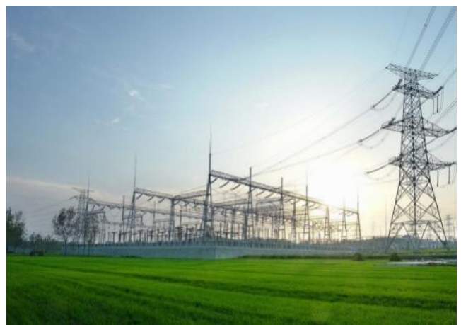
图17: 500 千伏淮宿变电站构支架
