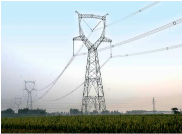
图14: 1000 千伏晋东南特高压示范工程中的角钢塔
