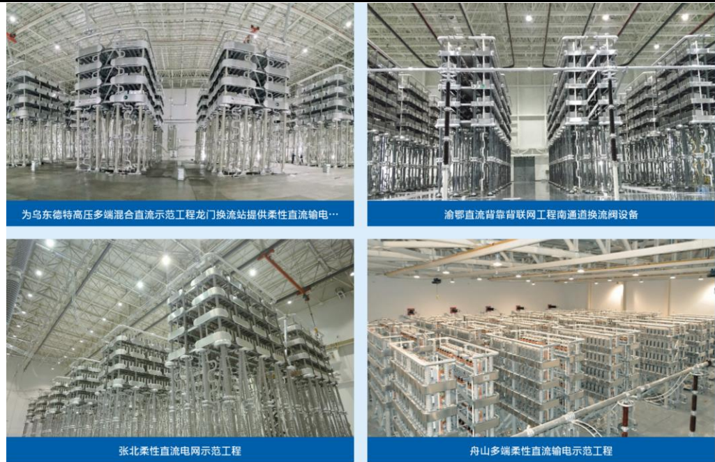
图 16：公司直流换流阀产品应用工程
