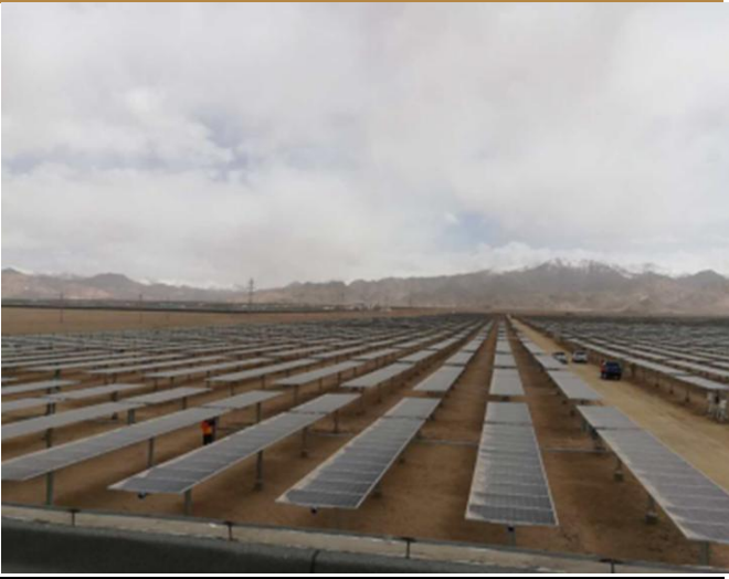
图：黄河水电格尔木 90MWP 平单轴跟踪项目
