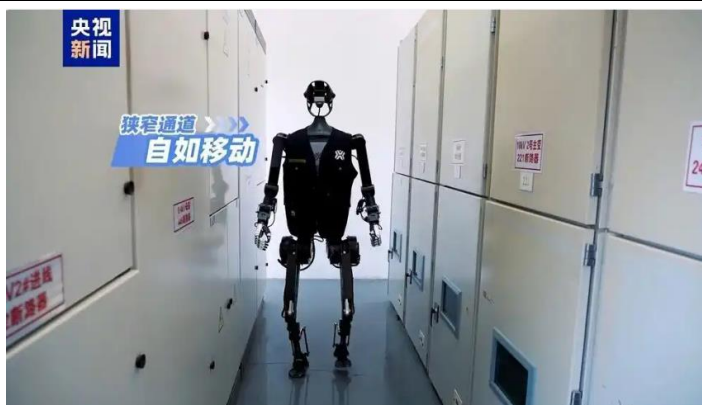
图11：“天工”人形机器人已顺利完成复杂倒闸操作
