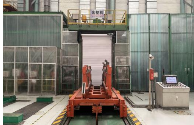
图9：冷轧总厂5#镀锌机组光整机
