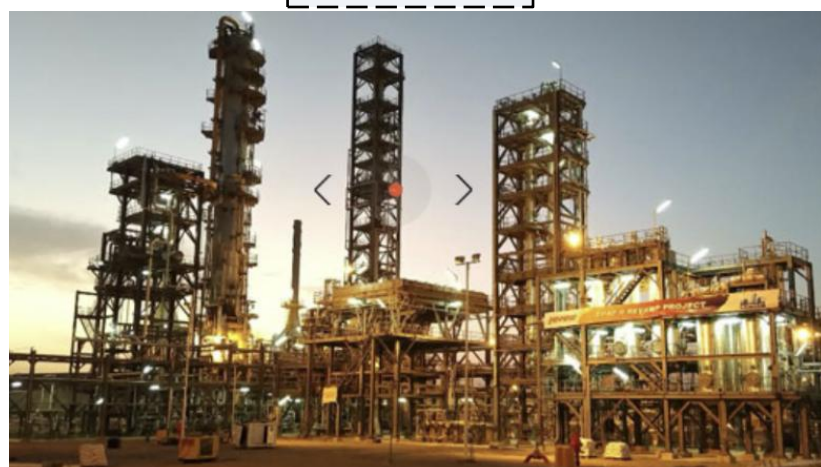
KOC项目生产设施
