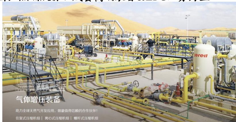
天然气增压装备
