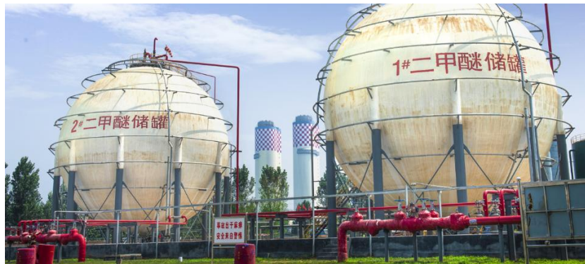
图：公司二甲醚储罐
