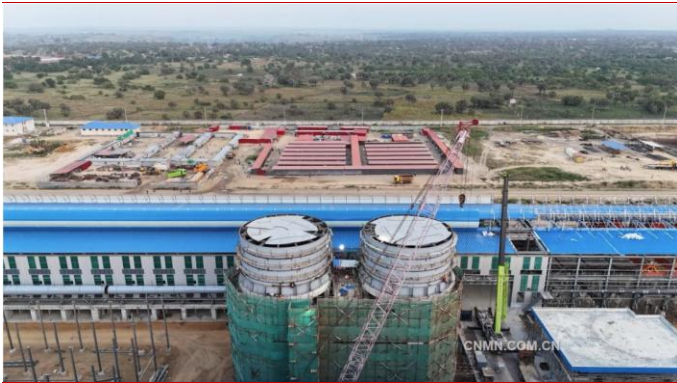
图1：项目核心设施—新鲜氧化铝仓和含氟氧化铝仓主体钢结构顺利封顶
