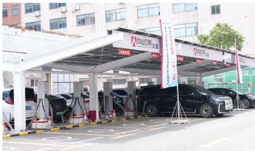
图 16：公司建设的光储充超充站
