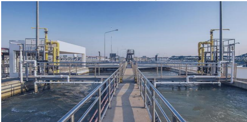
图：水处理膜组件、含油废水处理装置（膜式）
