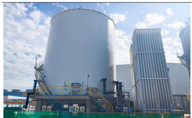
图2：金风科技兴安盟绿色甲醇项目（一期）设施
