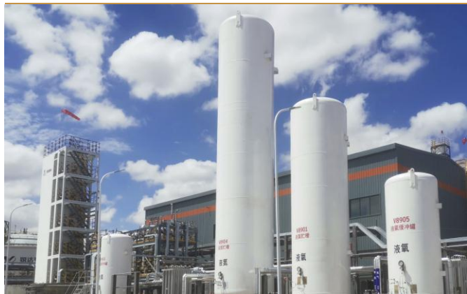
图 48：内蒙古 LNG-BOG 提氮项目
