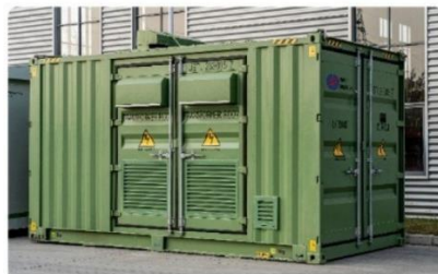
中压箱式变电站
