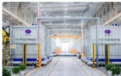
电池储能系统 16~24周生产周期
