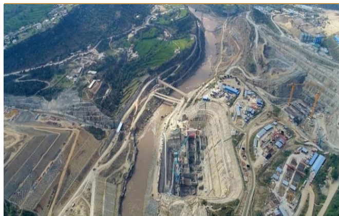
图 3：巴基斯坦 NJ 水电站
