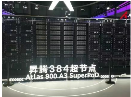
图15: 昇腾 384 超节点液冷机柜
