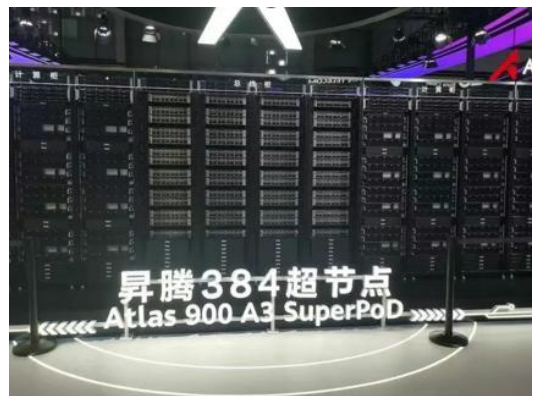
图15: 昇腾 384 超节点液冷机柜
