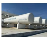
3台400m³ 液氧贮罐
