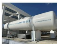
氧氮库区150m³ 液氧贮罐
