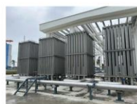
氧氮库区4台增压器
