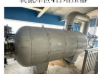
3m³ 液氧收集罐
