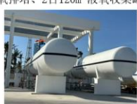
2台120m³ 液氮贮罐
