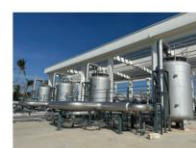
氧氮库区及塔上5台液氧过冷器
