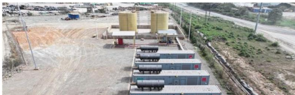
图19: Kinsevere 新增备用发电机组
