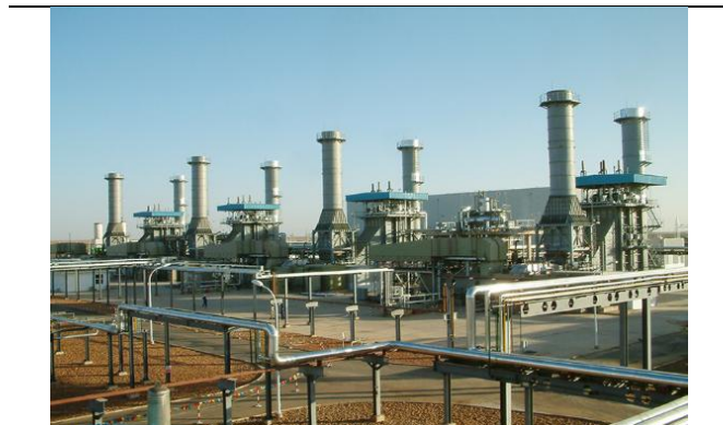
图 44：苏丹吉利燃机电厂一期工程 PG6581B 燃机余热锅炉
