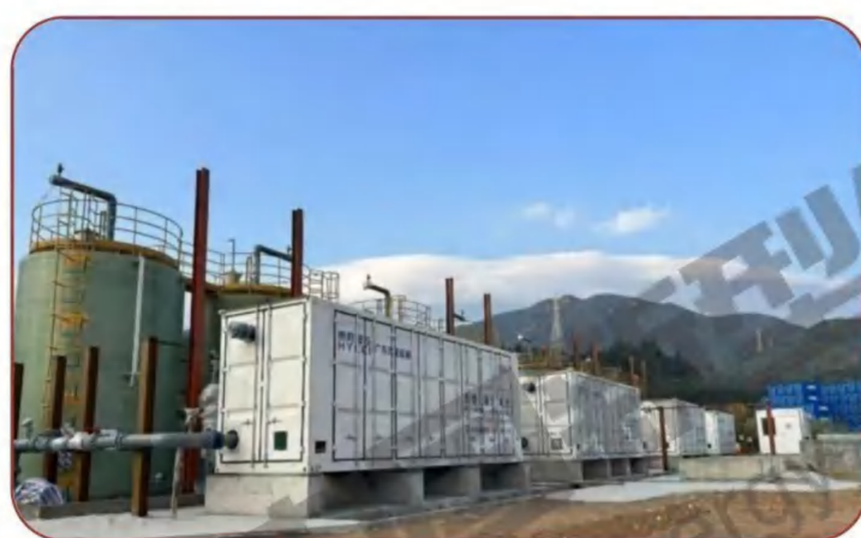
500kW 铁铬液流电池储能模块
