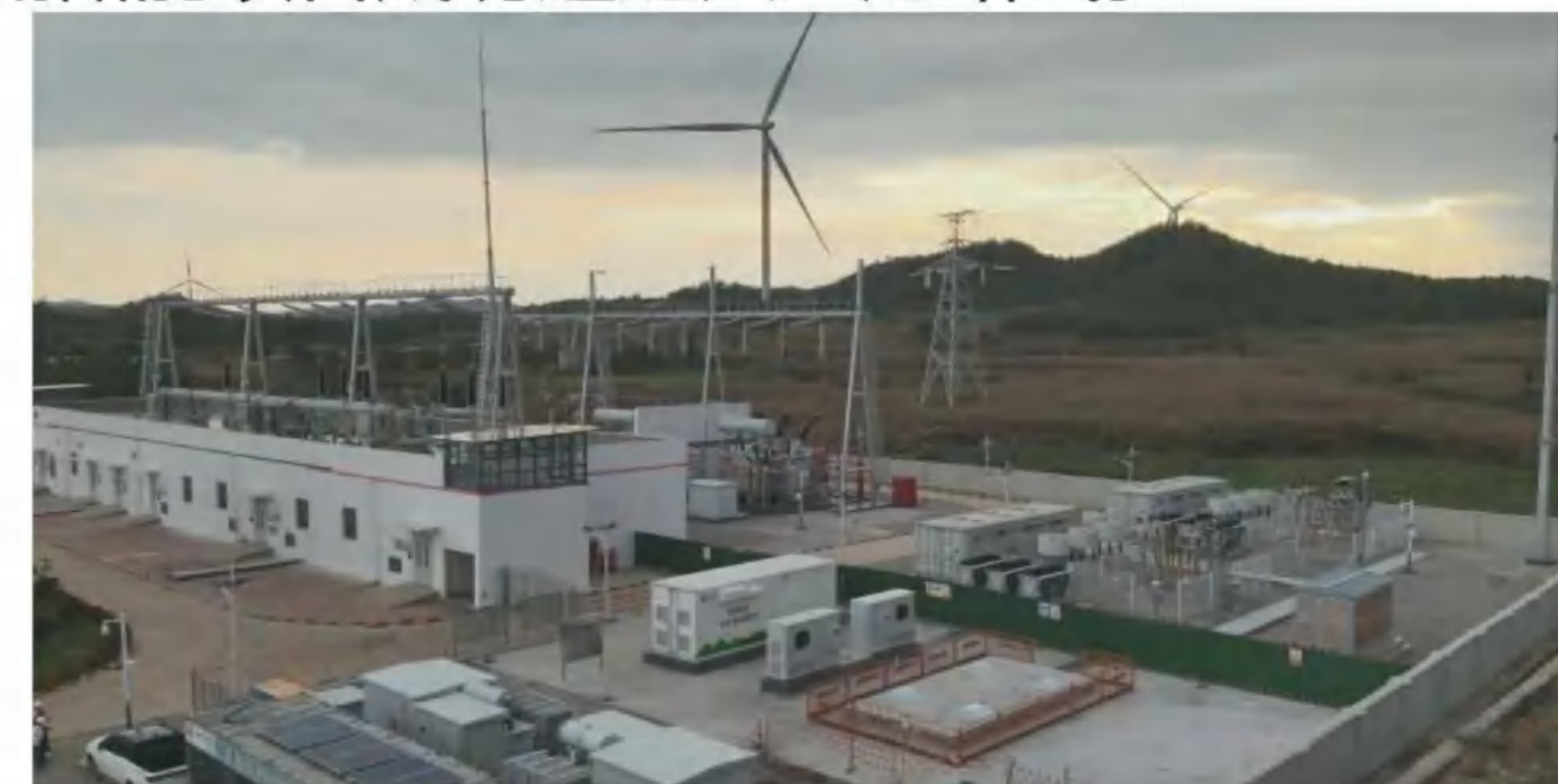
富源西风电场高惯量新型飞轮储能示范项目
