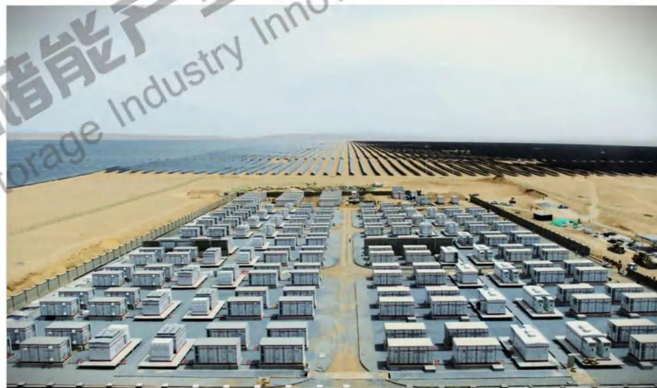
青海大柴旦100万千瓦风光储项目配套储能电站工程
