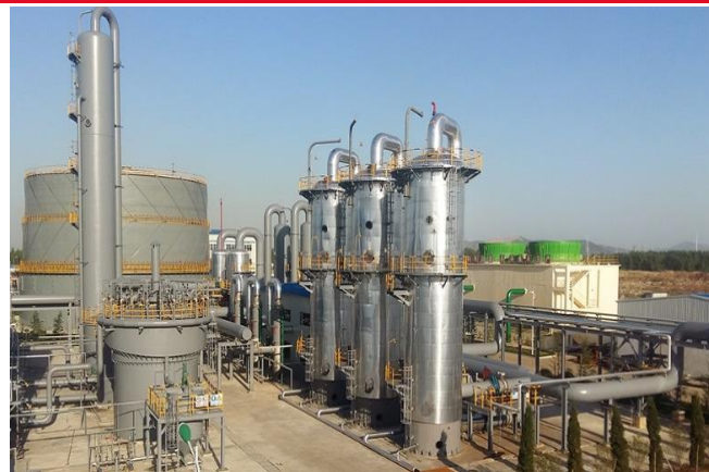
图26 陕鼓总包某焦炉煤气制 LNG 项目
