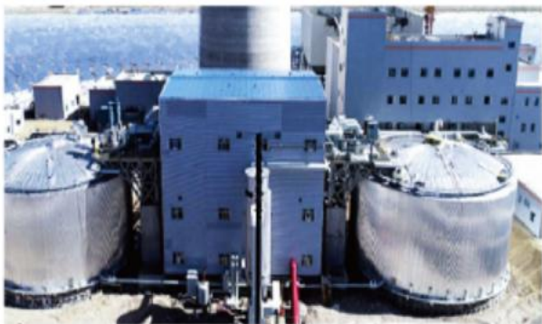
图37: 立式熔盐储罐
