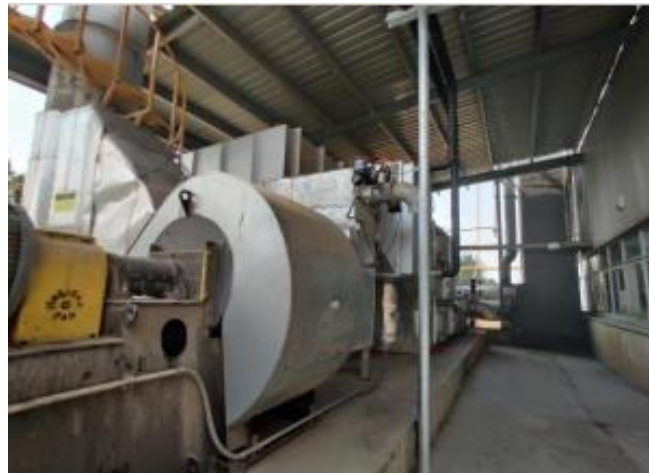
图 59：河北制罐余热回收项目
