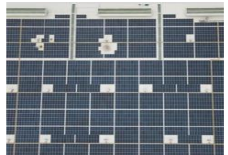
图 67: 安徽宝钢制罐厂屋顶分布式光伏发电系统
