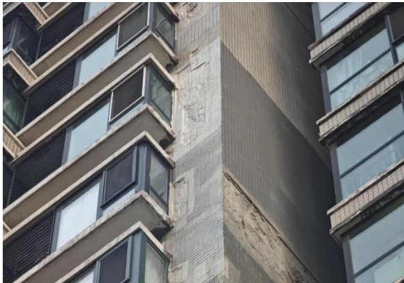
图表：老旧房屋外墙脱落
