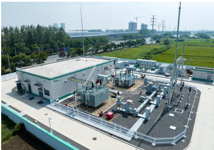
图4: 芜湖数据中心"源网荷储一体化"项目
