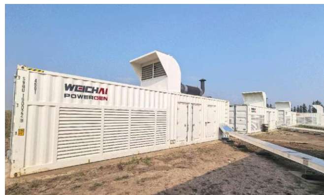
图：潍柴燃气发电机北美项目
