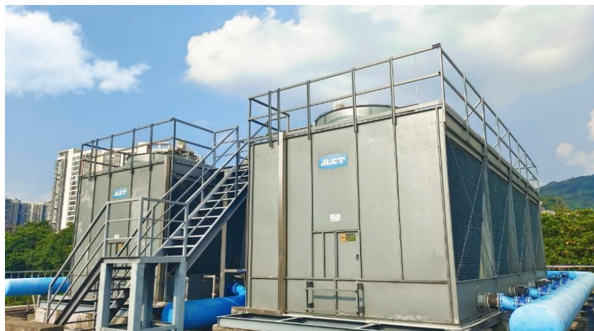
冷水系统冷却塔
