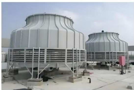
图5: 冷却塔的外观
