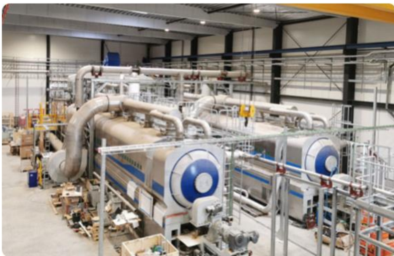
图 丹麦废塑料热裂解处置项目
