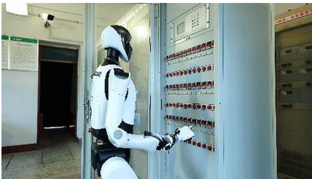
图表 6：电力机器人在四川内江某变电站实训
