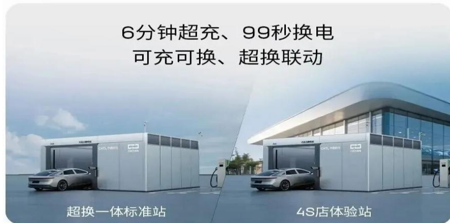
图 6、宁德时代发布会披露的超充换电一体站
