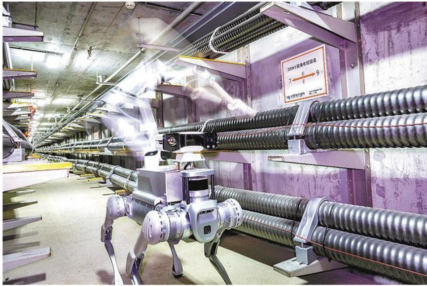
图 3.11: 电缆隧道机器狗巡检作业示意 [1]
