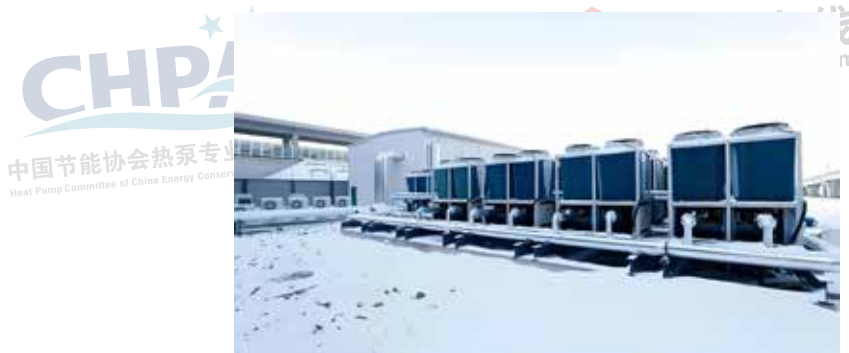
图 6-3 高铁站采用热泵系统
