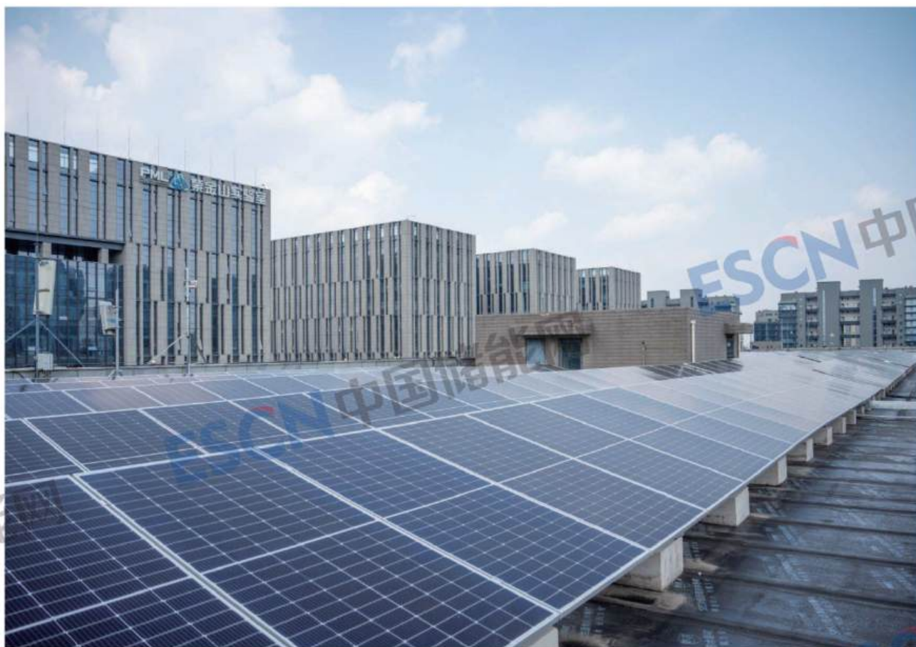
图 8-2 南京无线谷低碳智慧园区光储一体化微电网
