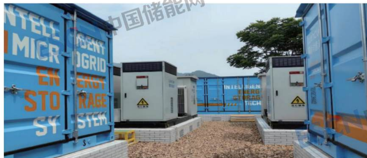
图 8-14 葛洲坝宜城水泥有限公司工业绿色微电网储能系统
