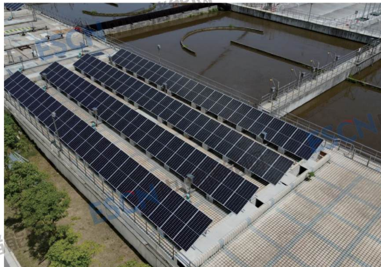
图 8-3 苏州循环经济产业园区污泥处置厂分布式光伏
