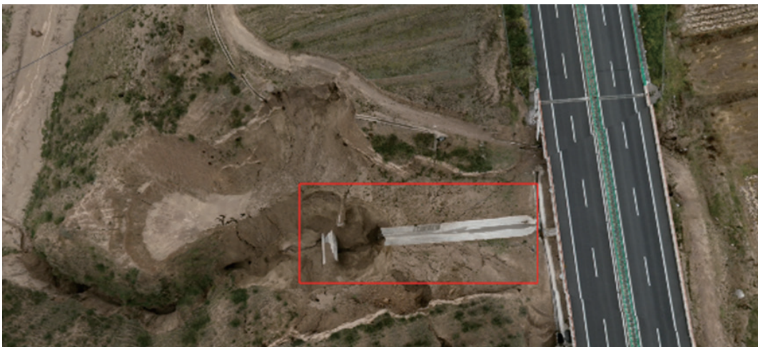
图 3-41 排水设施损坏
