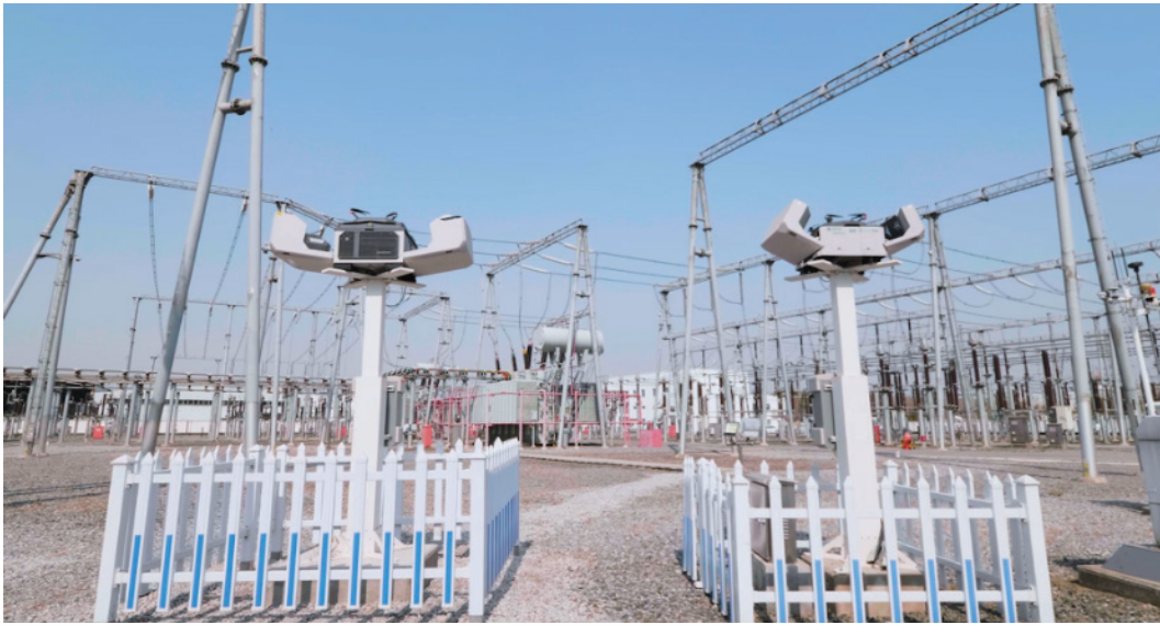
图 3-8 国网泰州供电公司引入 207 套大疆机场
