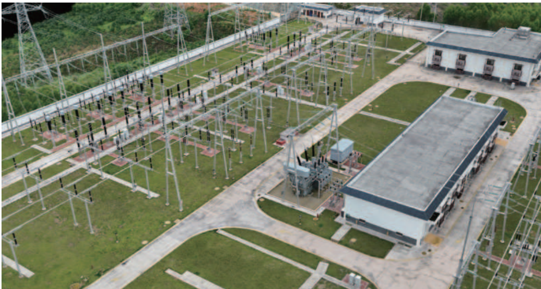
图 3-6 基于高斯泼溅技术重建的变电站模型
