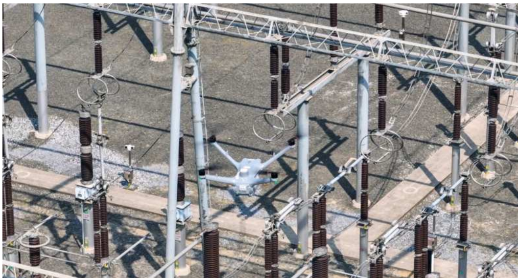
图 3-10 无人机巡检变电站
