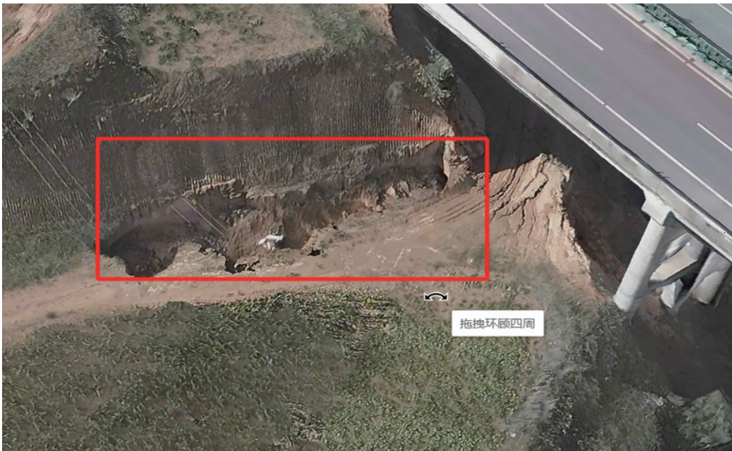
图 3-40 边坡底部垮塌
