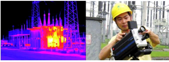
图26、红外热成像技术在电力检测领域的应用
