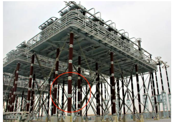
图10：棒形绝缘子应用于晋东南—南阳—荆门交流 1100KV 工程串补平台
