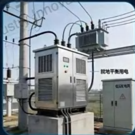
台区储能系统
