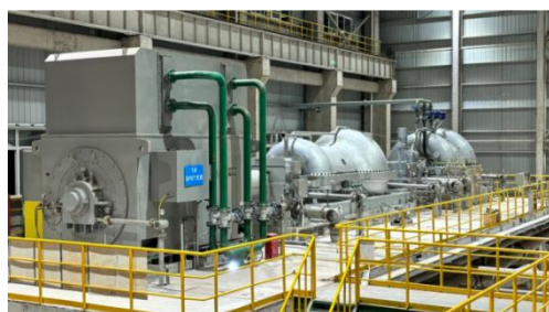
图7：高炉鼓风和煤气余压能量回收机组
