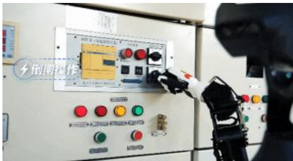
图59：天工完成精准倒闸工作
