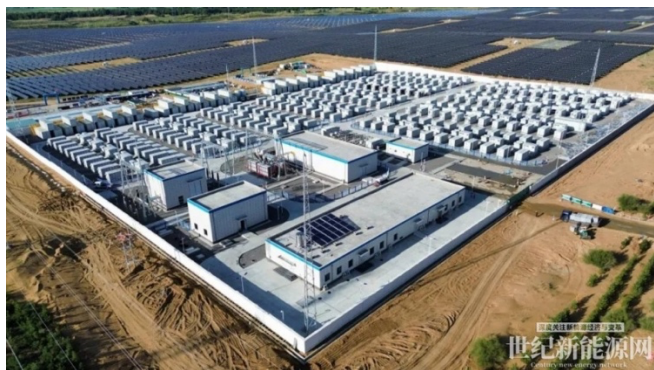
图表18：我国液流电池和新型压缩空气储能电站
