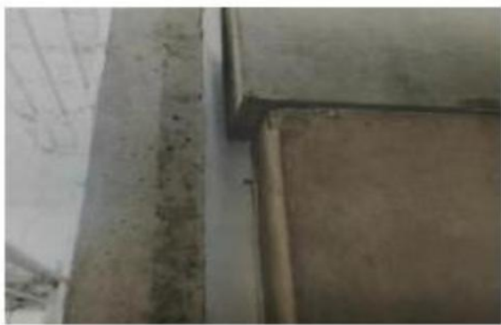
图7：装配式建筑预制构件安装偏差超出允许范围
