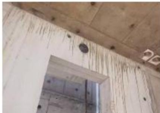
图8：装配式建筑预制墙板与铝模拼缝处漏浆、不平整
