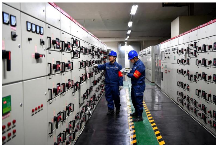
图 贵阳供电局工作人员在配电房开展巡视工作
