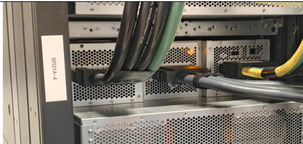
图23：Vera Rubin NVL72 在供电架构上实现由低压直流向 800V 高压直流的跃迁
