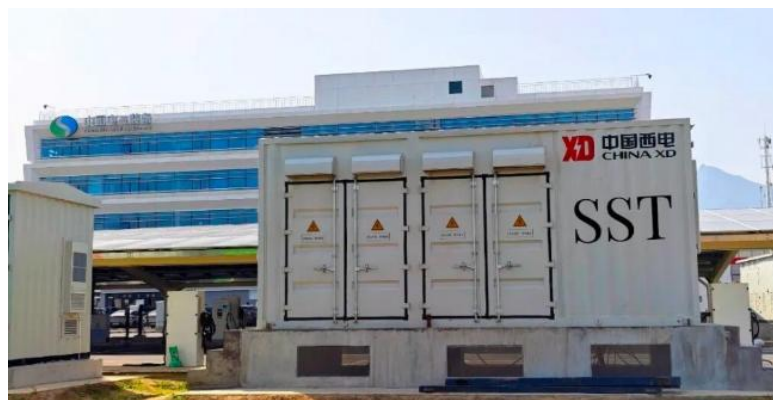
图：中国西电自主研发10千伏/2兆伏安/750伏固态变压器
